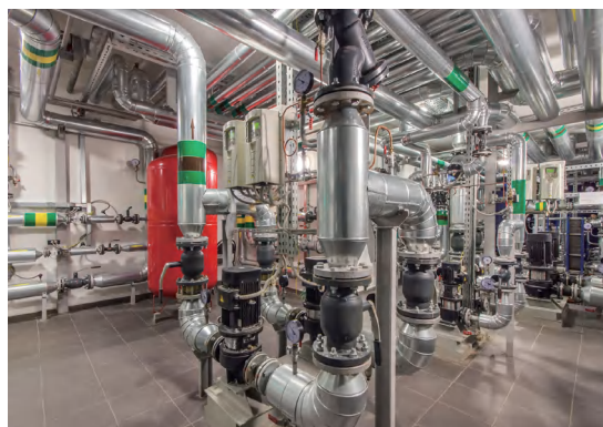
Sistema de calefacción urbana
